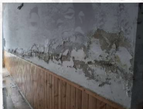
Ejemplo de humedad por capilaridad
