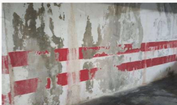
Ejemplo de humedad por filtración lateral
