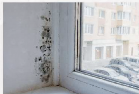
Ejemplo de humedad por condensación
